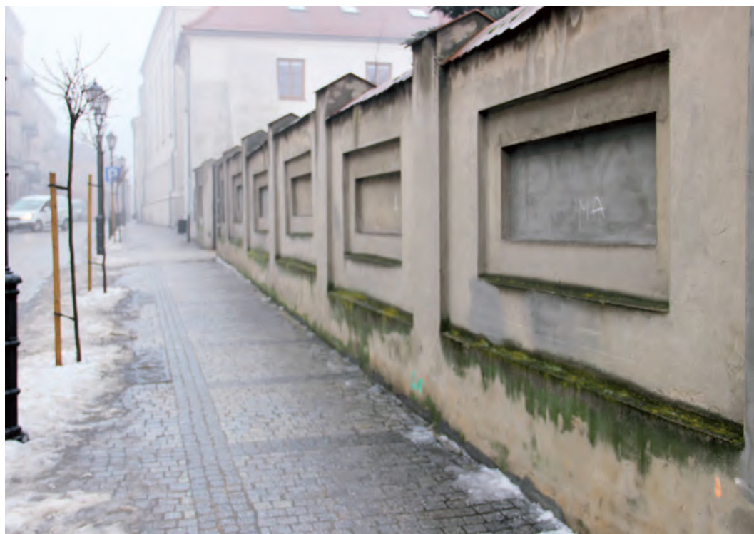
Parkan przy ul. Rycerskiej, z widocznym w złym stanie technicznym zwieńczeniem muru, stan przed remontem.
